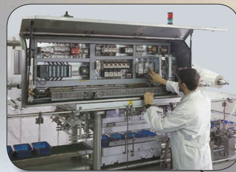
Quadro elettrico. Electrical panel. Armoire électrique. Schaltschrank. Cuadro eléctrico.
